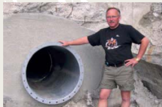
Anleggsleder og artikkelforfatter Nils Magne Bye ved røruttak for evt. minikraftverk.
