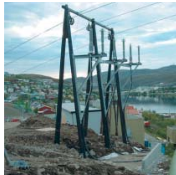
Kabelanlegg i Hammerfest med ferdige endeavslutninger
