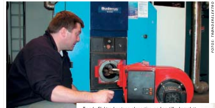
TrønderElektro har topp ekspertise, og kan tilby komplett oljefyringservice, samt drifting av slike anlegg.
